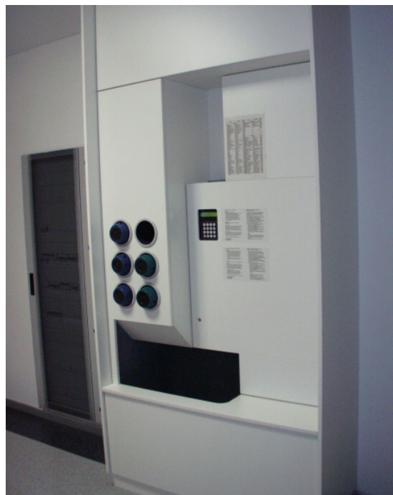
Rohrpoststation auf Abteilungsebene: Die RFID-Technik bleibt unsichtbar.
